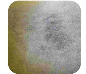
.Erosione da sterco e urina .Excrement and urine erosion .Erosion due à excrement et urine .Erosion durch Exkremente
